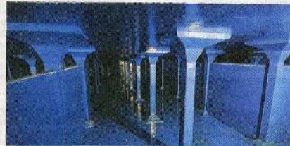
Фабрика Макиш 2 – резервоар чисте воде
