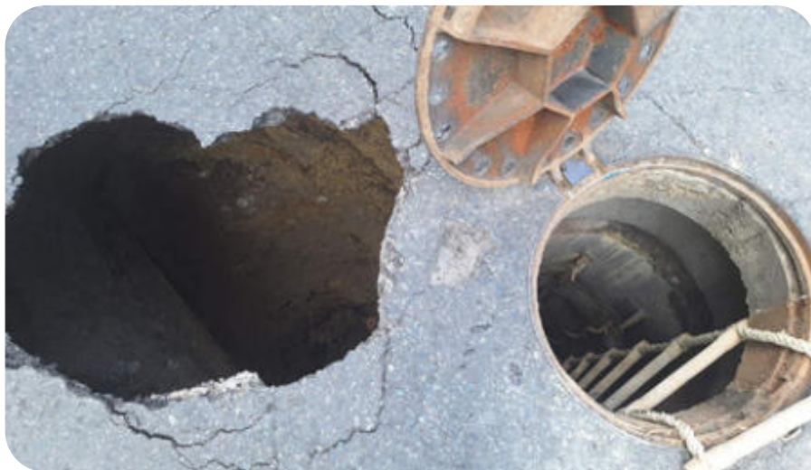
Услед дефекта на колектору дошло је до пуцања и отварања коловозне конструкције
